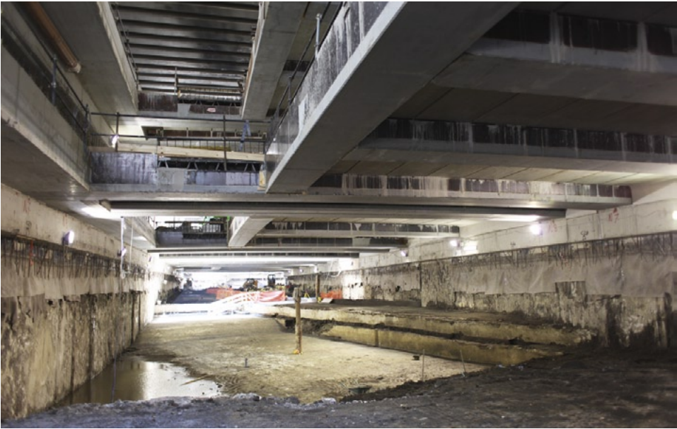
Fig. 3 – L'immagine ben rappresenta l'atipicità dello scavo e della documentazione grafica effettuata sotto copertura e durante la costruzione delle infrastrutture. Da notare l'illuminazione completamente artificiale.
