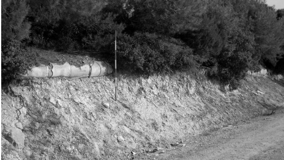
Fig. 11 – Tratto di condotta messo in luce in seguito all'apertura di una strada moderna.
